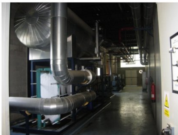
Fig.5.6. Sistema refrigeració, cambres frigorífiques
